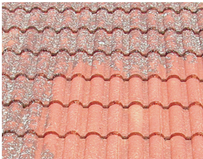
Tak av betongpannor med alger och lav, två år efter behandling av ett avgränsat parti.
