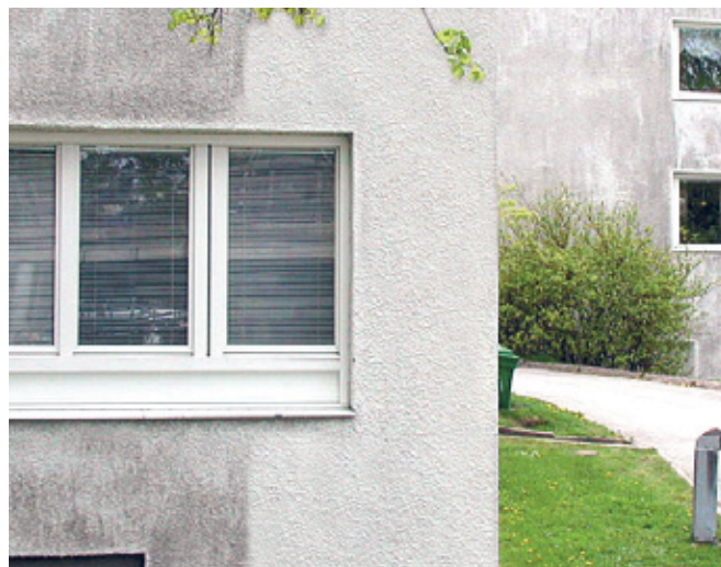
Fasad med påväxt av mögel och alger, ett år efter behandling av ett avgränsat parti.
